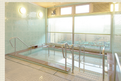
一般浴のほか、家庭のお風呂のような個浴、寝たきりの方も入浴可能な特殊浴槽があり、お身体の状態に合わせた入浴が可能です。
